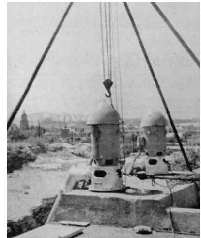
Conforme crecía la demanda de agua hubo necesidad de adquirir bombas nuevas para dotar de agua a la población.
