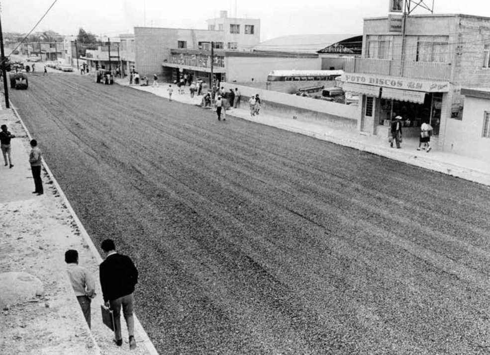
Al concluir la introducción de la tubería se pavimentaron las calles. La foto corresponde a V. Carranza frente a la Central de Autobuses.
