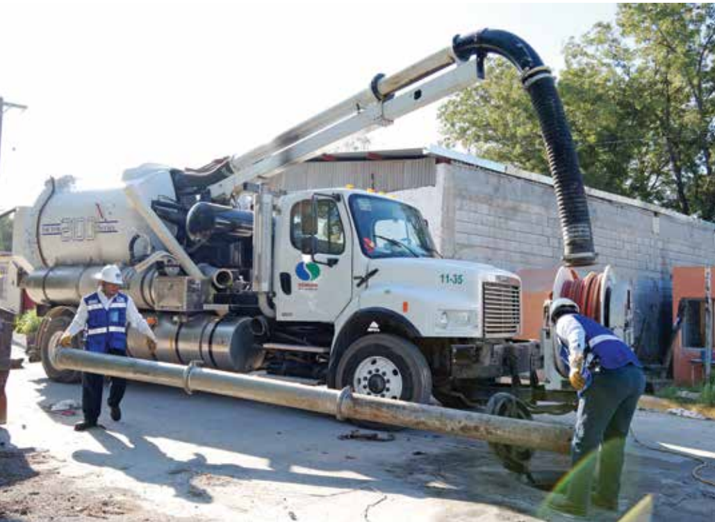
Equipo para liberar de obstrucciones el drenaje.
