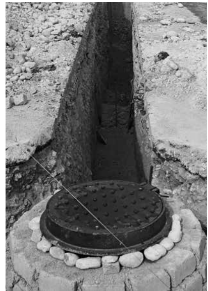
A la par de la introducción del agua potable el sistema de alcantarillado seguía avanzando.
