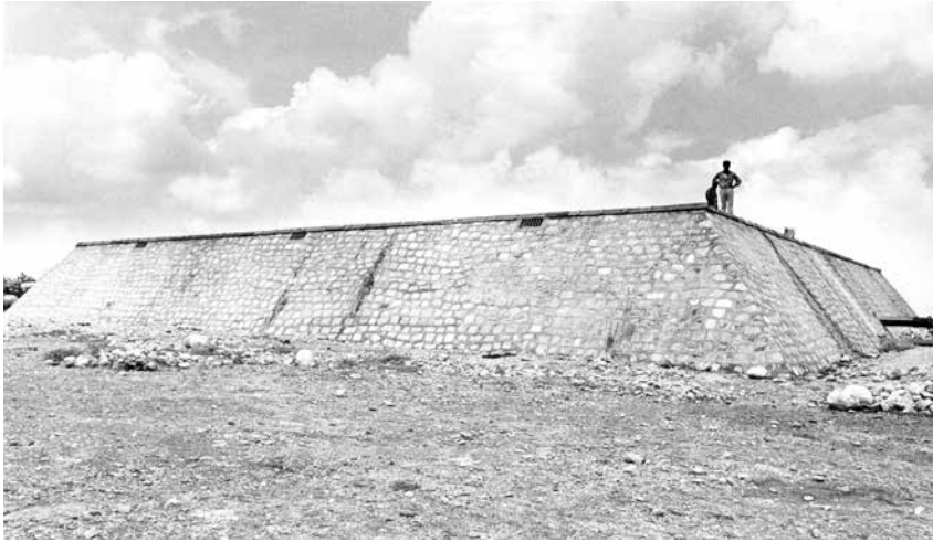
Se instalaron dos tanques de almacenamiento de agua; uno en la loma de La Ermita y el otro en la colonia La Loma.
