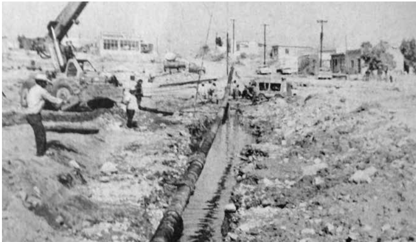
En varias colonias de Monclova y Frontera se continuó con la introducción de la tubería para el drenaje.
