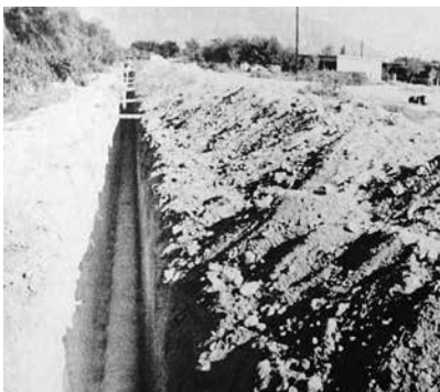
Ante la morosidad de los usuarios las obras del drenaje se suspendieron en diferentes ocasiones.
