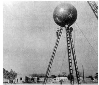
Para suministrar agua a los habitantes de Estancias de San Juan se instaló un tanque elevado.
